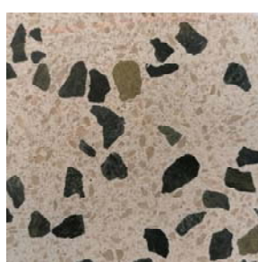
beton s agregatom separirane granulacije
