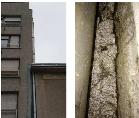
Slika 8.7 Stiropor u razdjelnici obložen limom na vanjskoj fasadi (Trnje, Zagreb)
